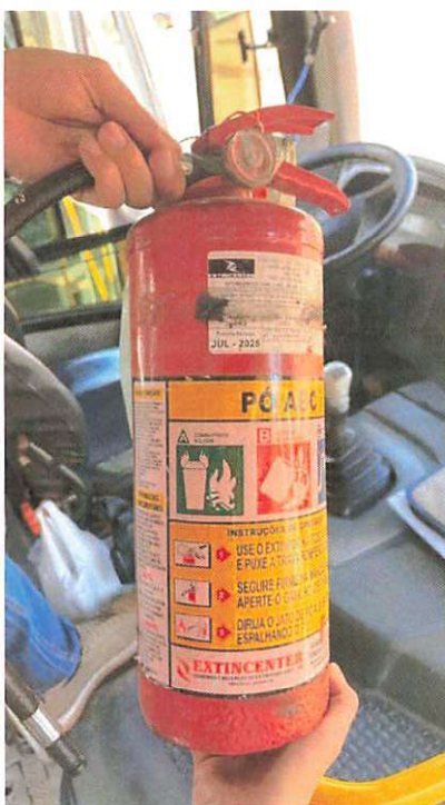
Imagem 6 – Extintor de incêndio vencido
